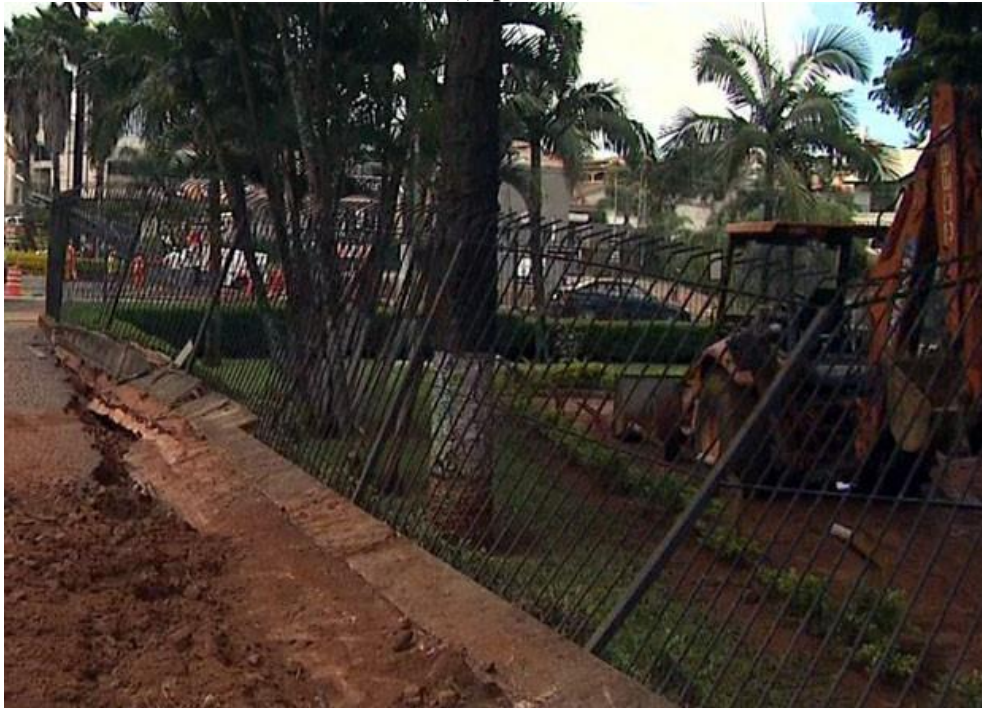
Foto 9 - Fórum Comarca de Franca (SP), após eventos chuvosos
