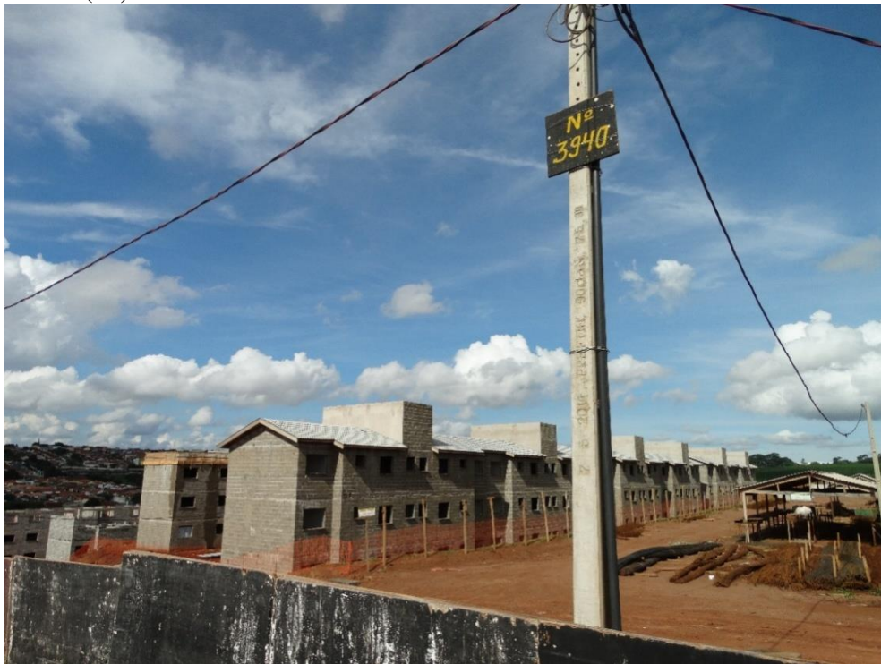
Foto 1 - Obras do Programa “Minha Casa Minha Vida” no Bairro Santa Efigênia, em Franca (SP)
