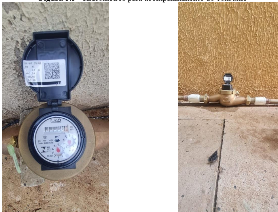
Figura 3.3 - Hidrômetros para acompanhamento do consumo
