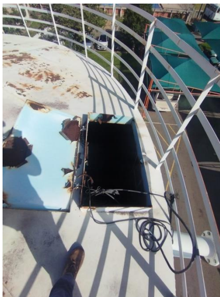
Figura 4.6 - Corrosão no reservatório de distribuição
