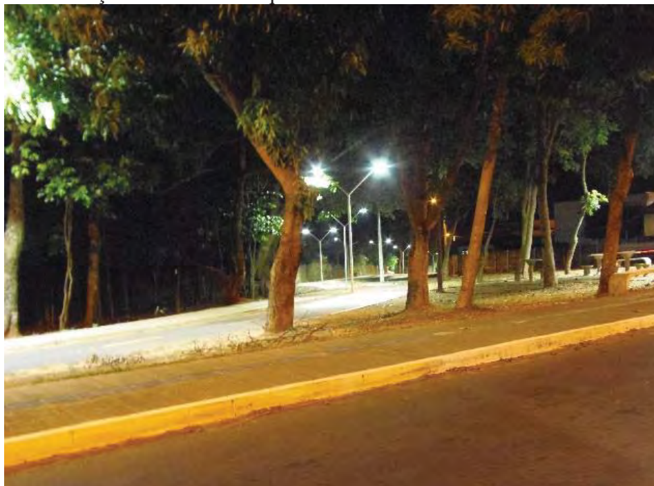
Foto 11: Iluminação de LED no Parque Santa Cruz.
