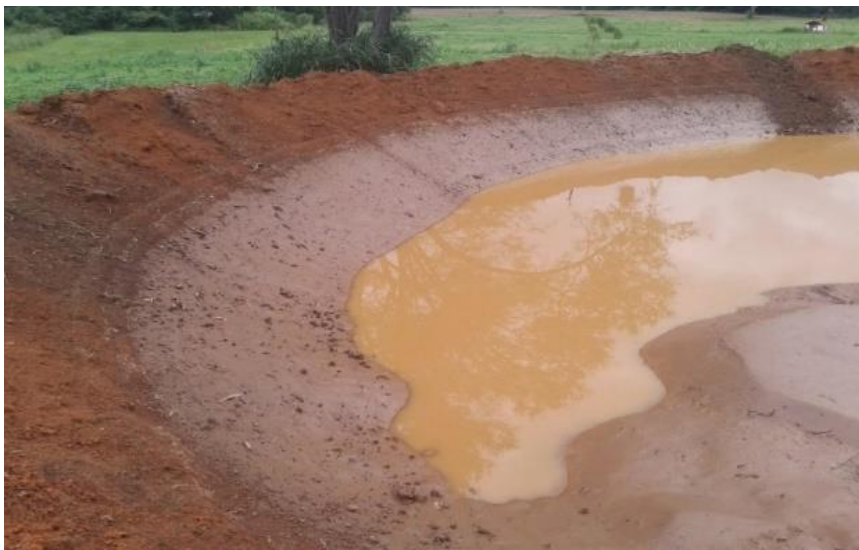
Figura 12 - Barraginha após a infiltração de um metro em um dia, a lama no talude ainda se encontra úmida
