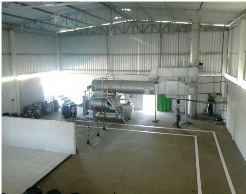
Figura 6 – Visão da indústria e do incinerador utilizado.
