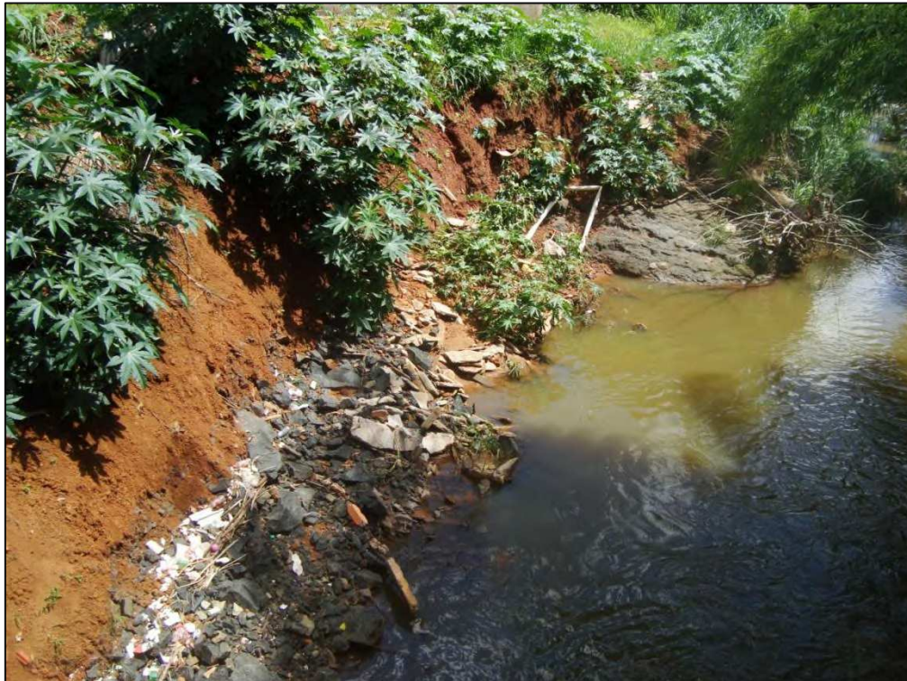
Foto 50 – Erosão no Ribeirão Pirapitinga – próximo ao Posto do Gaúcho. Autora: RIBEIRO, L. J. (2011).
