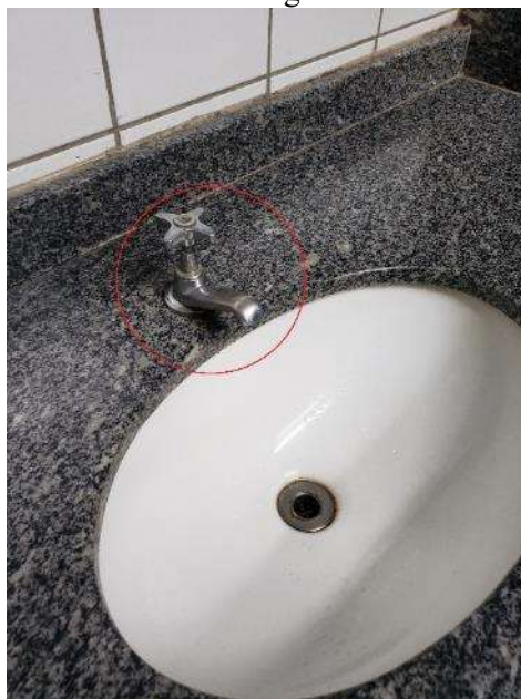
FIGURA 4.88 – Torneira curta em relação a disposição sobre bancada, instalada na Faculdade de Odontologia
