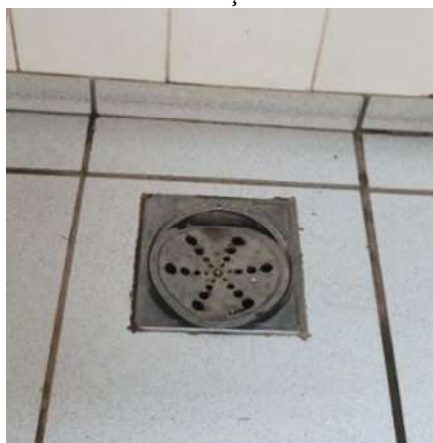
FIGURA 4.87 – Grelha de ralo com má fixação existente na Faculdade de Educação
