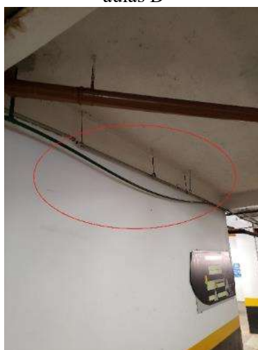
FIGURA 4.81 – Tubulação de água fria sem apoios apresentando flechas e ondulações no Centro de aulas D
