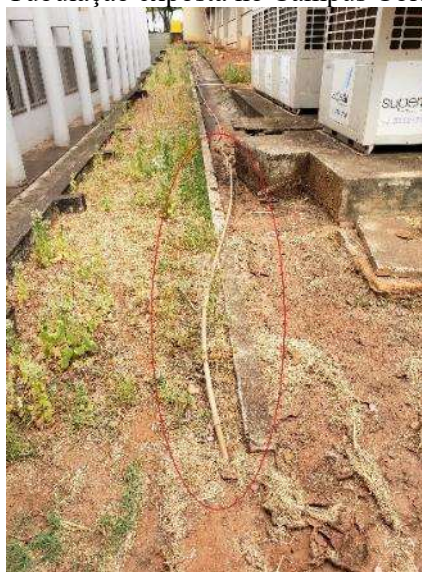
FIGURA 4.82 – Tubulação exposta no Campus Colemar Natal e Silva
