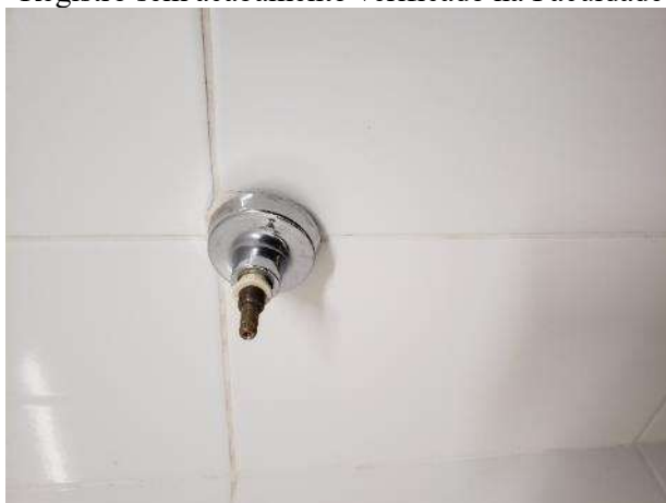
FIGURA 4.89 – Registro sem acabamento verificado na Faculdade de Educação
