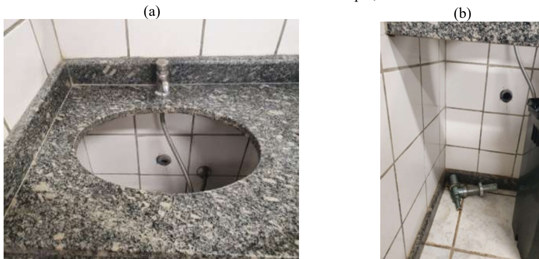
FIGURA 4.90 – Incidência de descolamento de cuba de pia, verificado na Faculdade de Medicina
