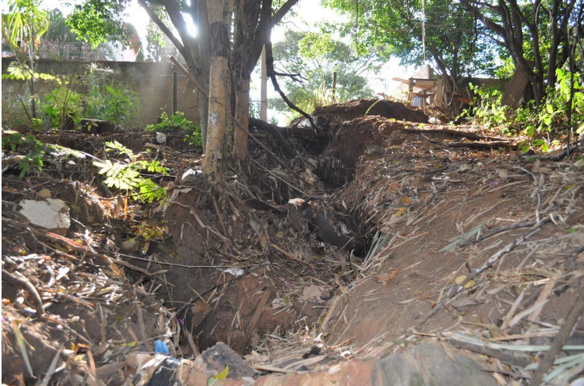
Fotografia 12 - Erosão provocada pelo escoamento superficial intenso, e disposição inadequada de resíduos sólidos na APP do Bairro Jardim Goianiense
