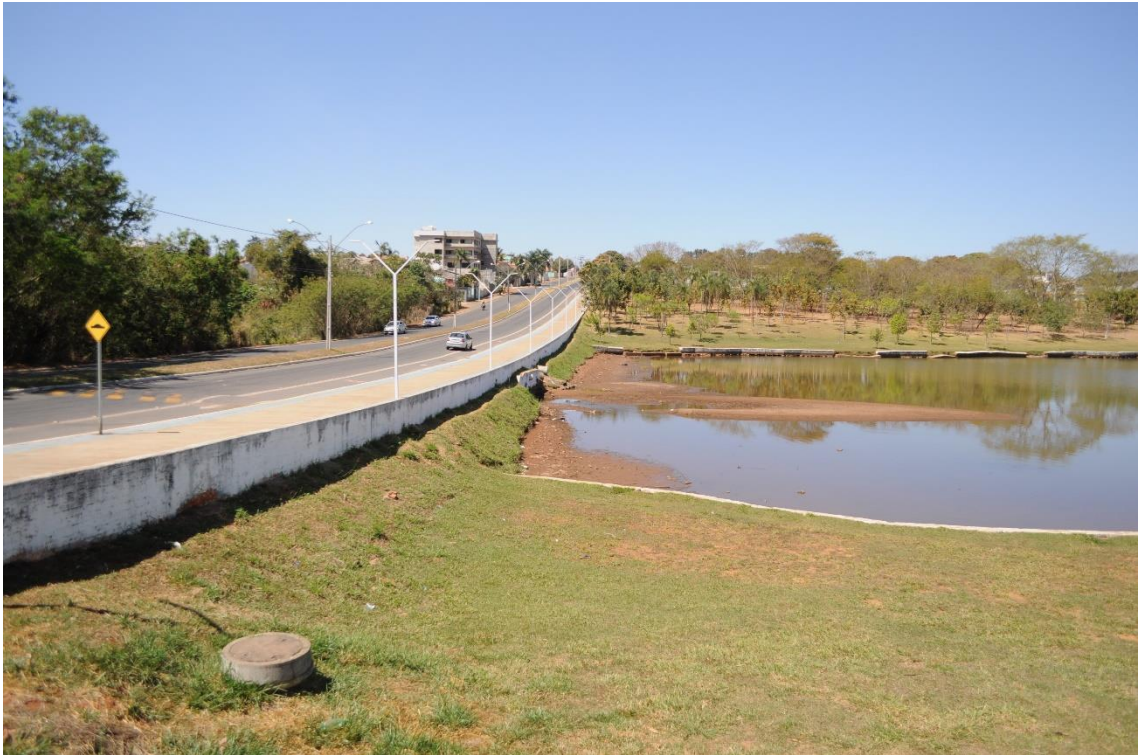
Fotografia 27- Assoreamento da Represa do Clube do Povo
