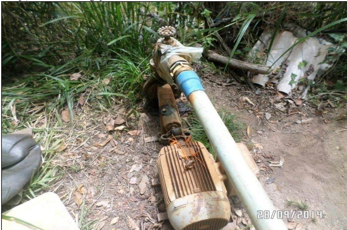
Foto 7 - Bacia Hidrográfica do ribeirão Samambaia/Catalão (GO): observe o lacre da SAE (cor laranja) na bomba de irrigação.
