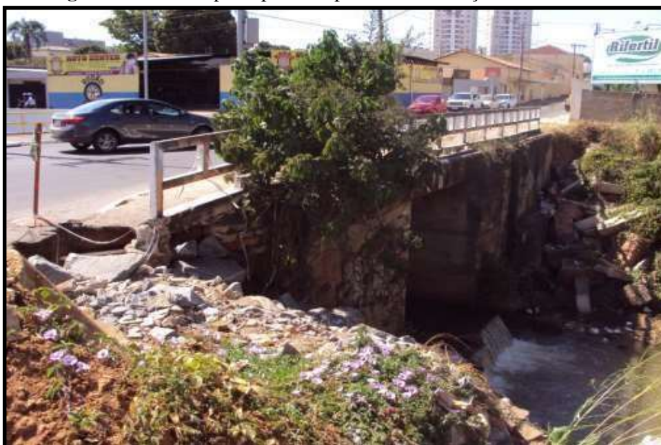
Figura 14: Erosão após a primeira parte da canalização no ano de 2018
