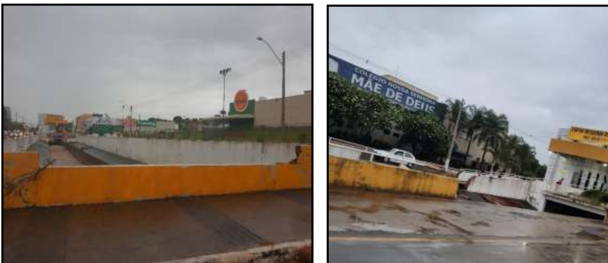
Figuras 33 e 34: Estragos na estrutura da Canalização
