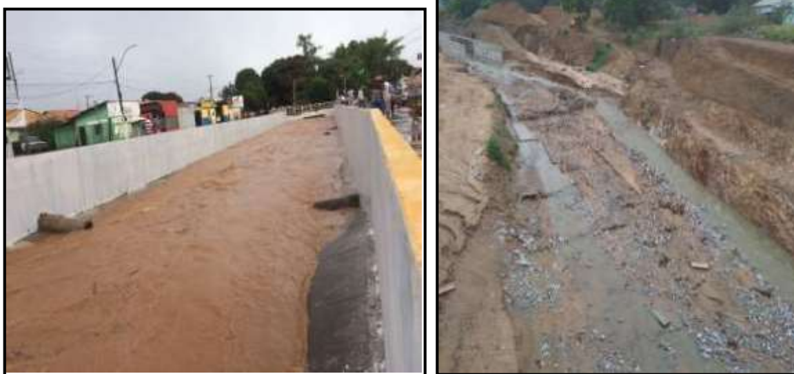
Figuras 29 e 30: Canalização e área de expansão da nova canalização após chuva em Catalão
