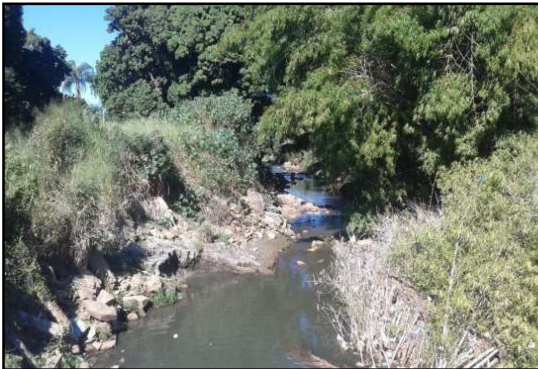
Figura 17: Degradação da área ao fim da canalização no ano de 2018
