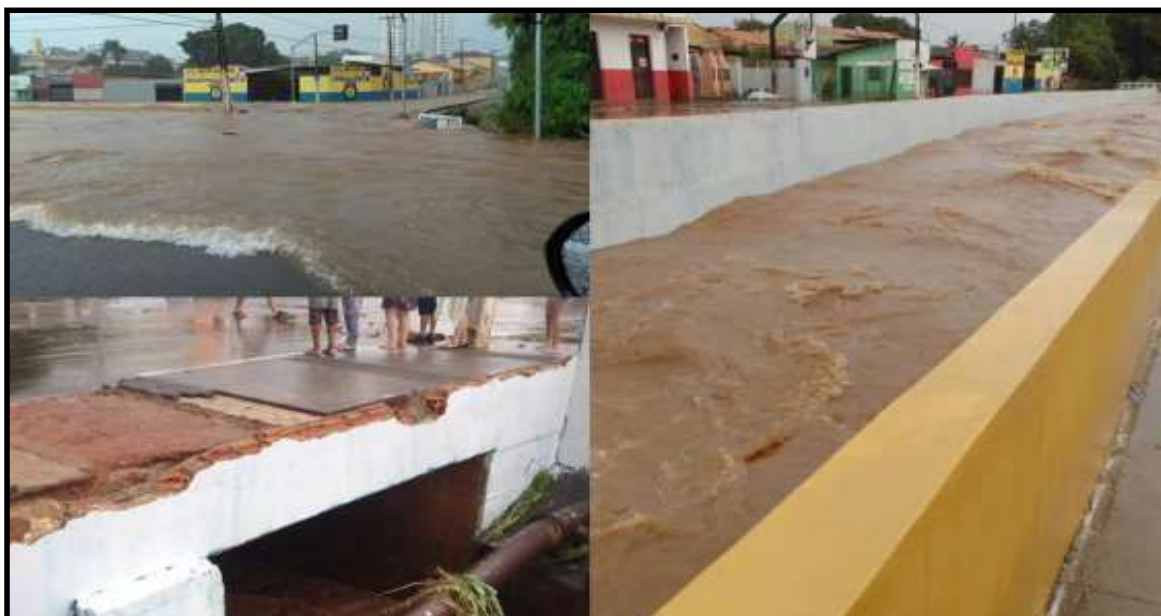
Figura 28: Canalização não suporta o quantitativo de chuva e inunda a Avenida Raulina Fonseca Paschoal
