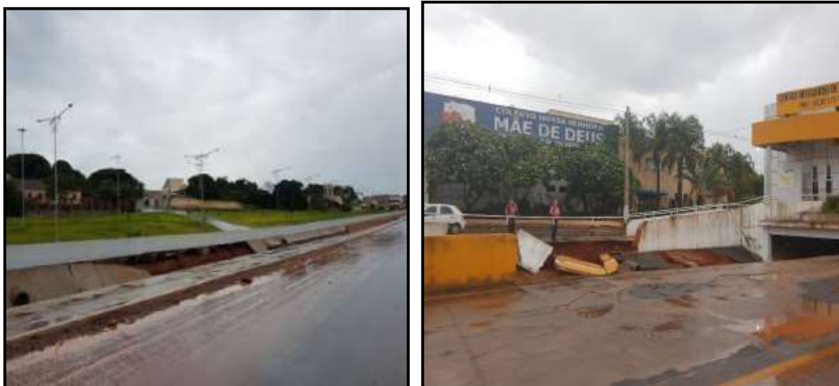
Figuras 37 e 38: Comprometimento da estrutura da velha e nova canalização
