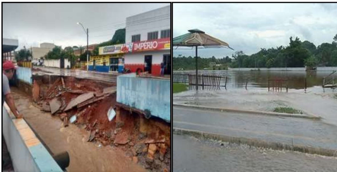
Figura 26 e 27: Estrutura da canalização desaba após chuva e Represa do complexo Cassiano Martins transborda após chuva no ano de 2019
