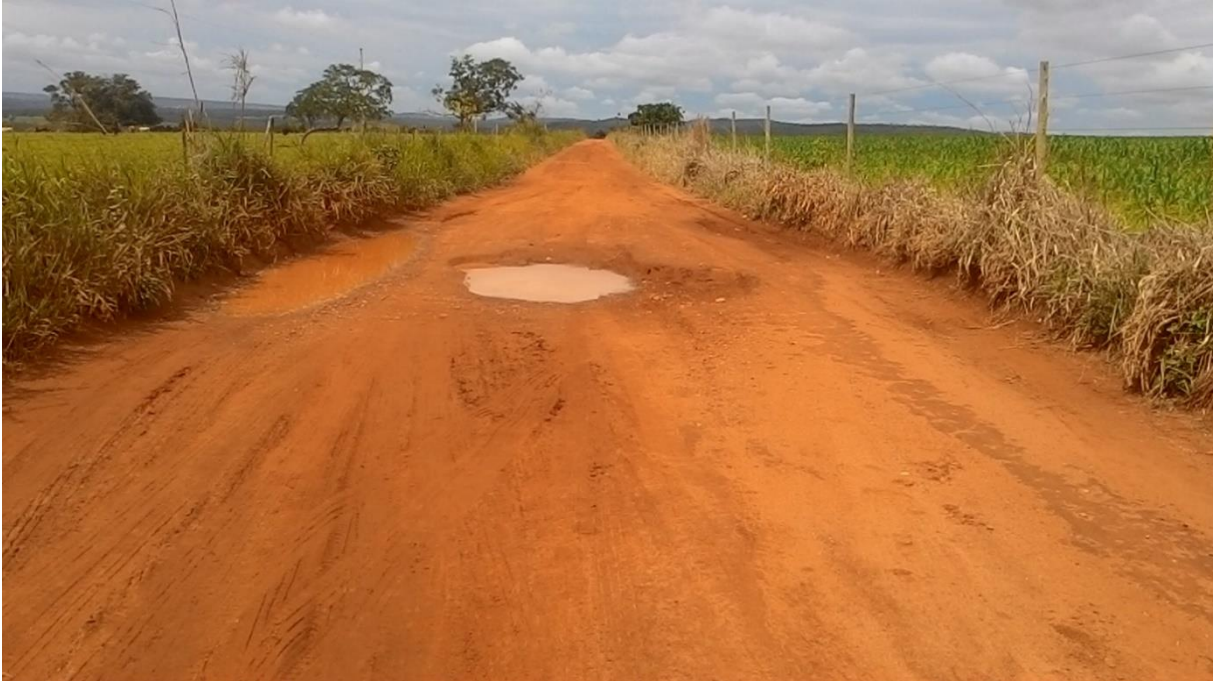
Figura 6 - Estrada vicinal no início do período chuvoso que já apresenta buracos que acumulam água da chuva
