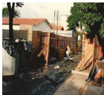
Área de contaminação isolada por tapumes
