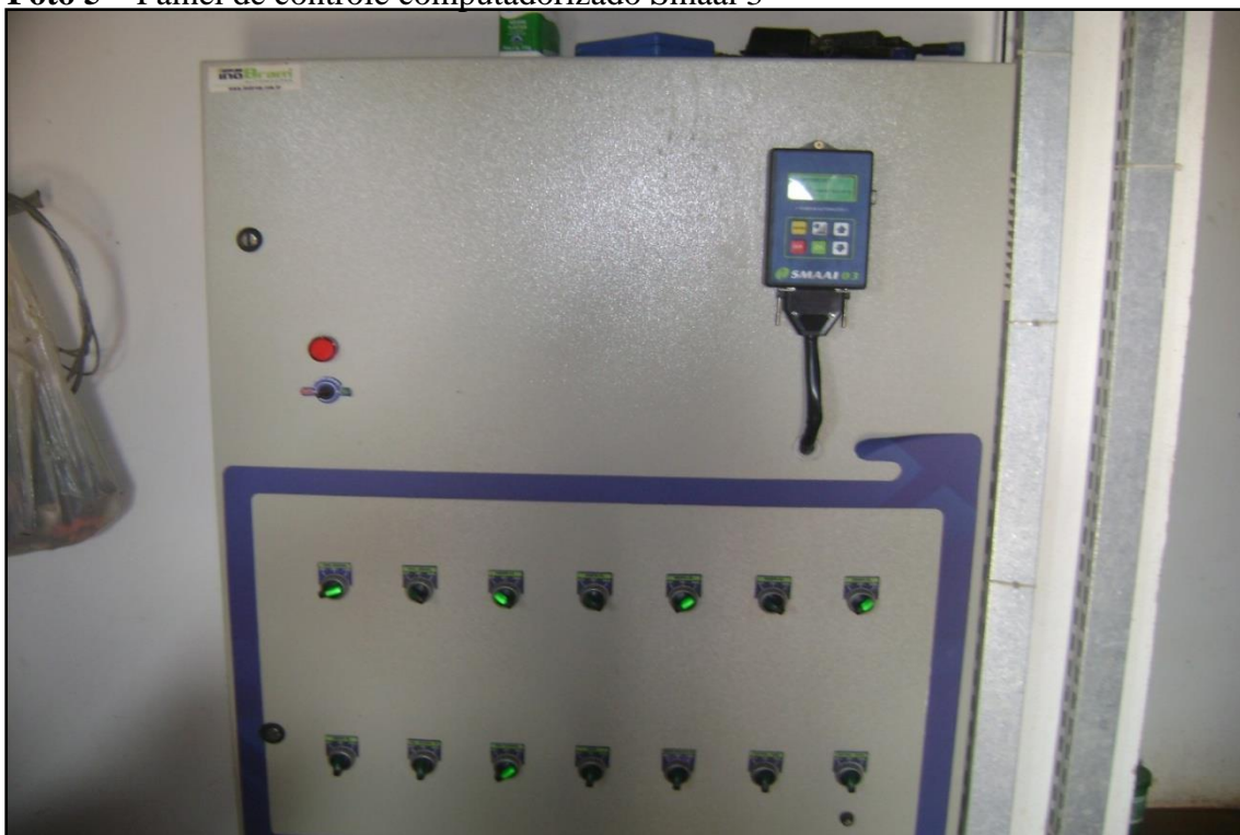
Foto 5 – Painel de controle computadorizado Smaai 3
