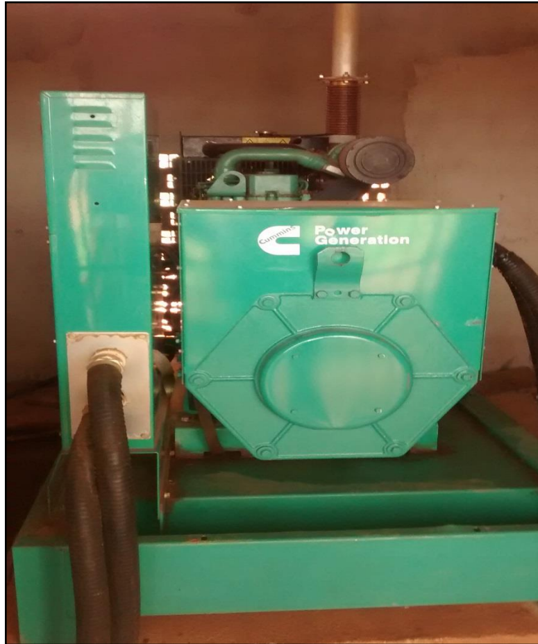
Foto 11 – Gerador de energia
