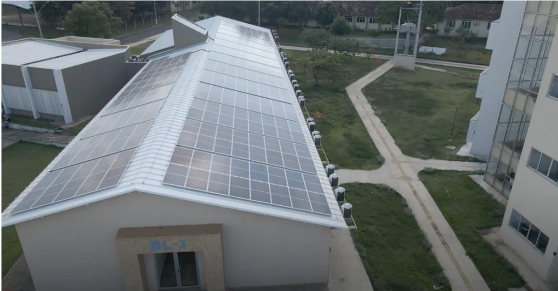
Figura 26 - Usina Fotovoltaica - Bloco J - 127,75 MWh/ano.
