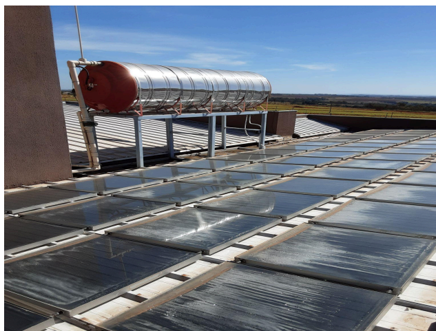
Figura 7 - Boiler e placas do SAS.
