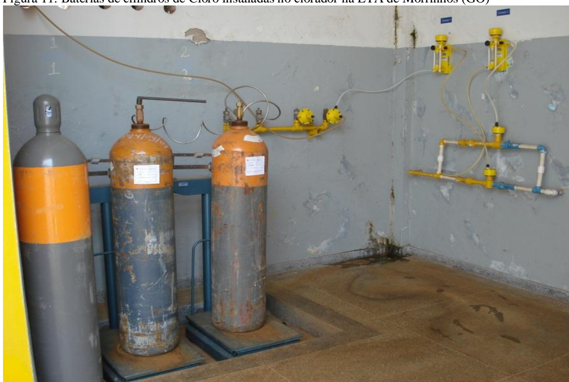
Figura 11: Baterias de cilindros de Cloro instaladas no clorador na ETA de Morrinhos (GO)
