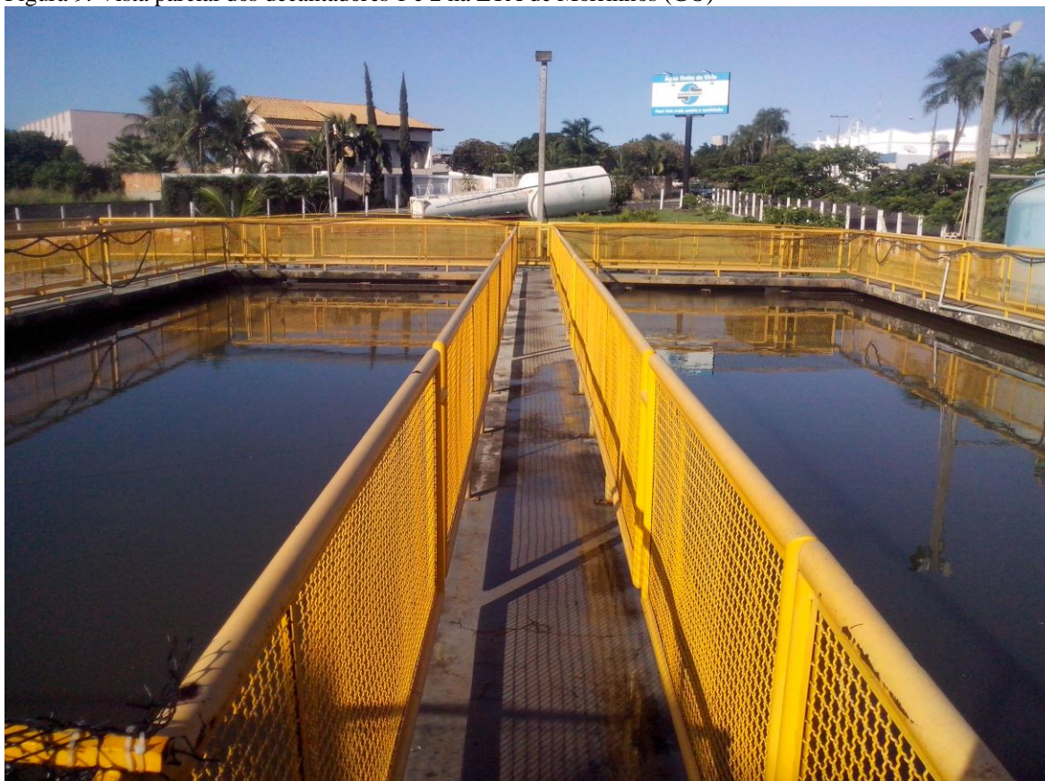
Figura 9: Vista parcial dos decantadores 1 e 2 na ETA de Morrinhos (GO)
