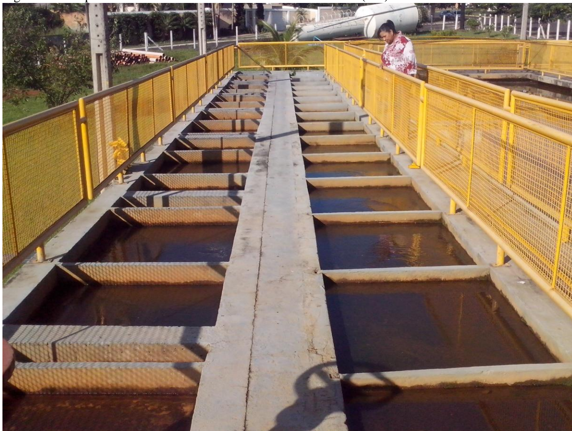
Figura 8: Vista parcial dos floculadores 1 e 2 na ETA de Morrinhos (GO)
