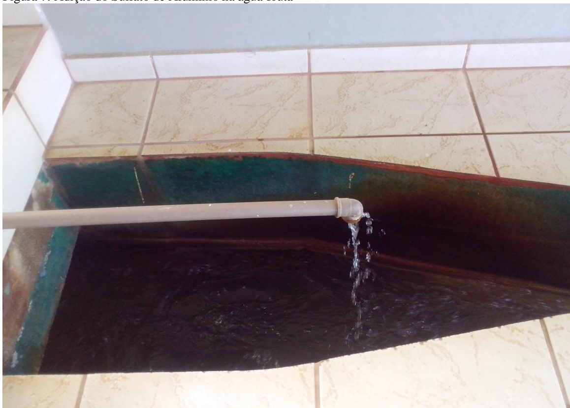
Figura 7: Adição do Sulfato de Alumínio na água bruta
