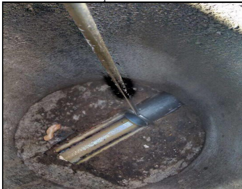
Foto 6 - Demonstração dos efluentes do empreendimento no fundo da caixa de decantação
