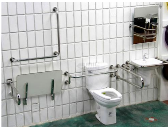
Fig. 01. Acessibilidade em Banheiros.
