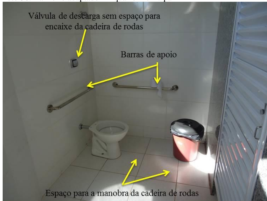
Foto 36: Banheiro adaptado – Aquário Municipal
