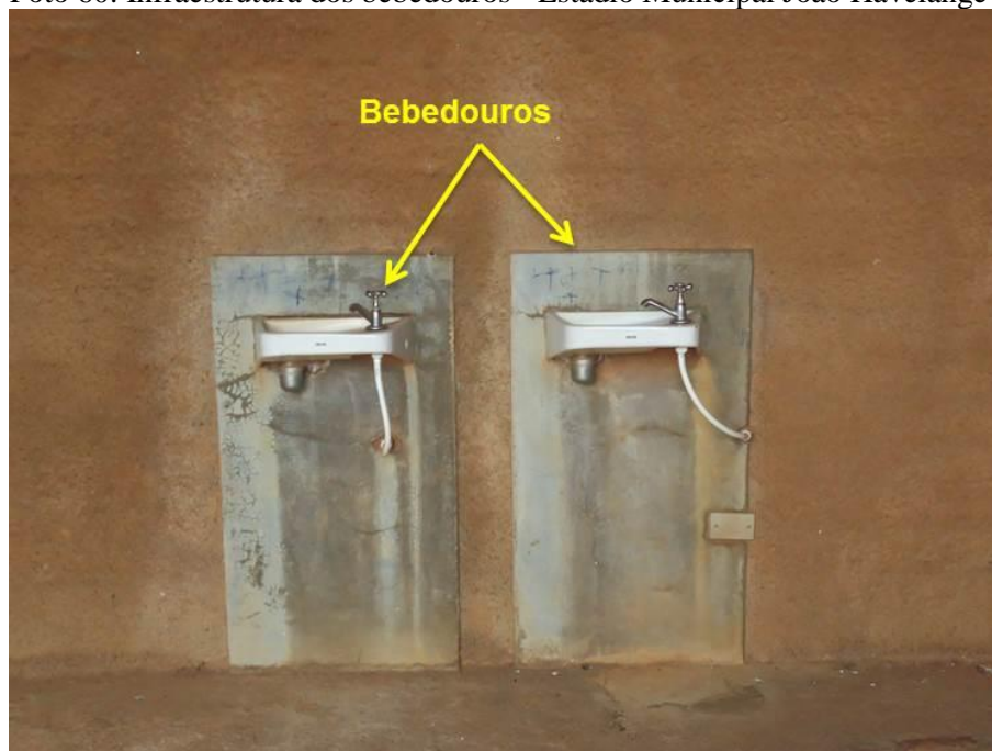
Foto 60: Infraestrutura dos bebedouros - Estádio Municipal João Havelange
