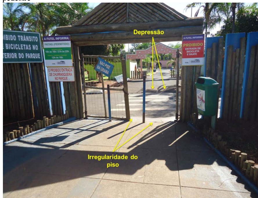
Foto 17: Irregularidade e depressão na interseção do piso com a faixa de pedestre
