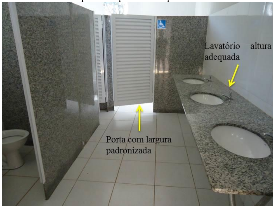
Foto 37: Banheiro adaptado – Aquário Municipal
