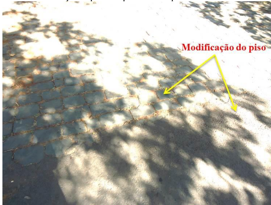
Foto 32: Modificação de piso – Aquário Municipal
