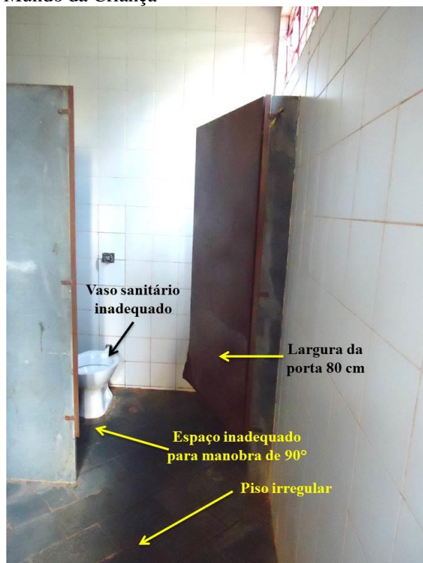
Foto 43: Sanitário adaptado de forma inadequada – Mundo da Criança
