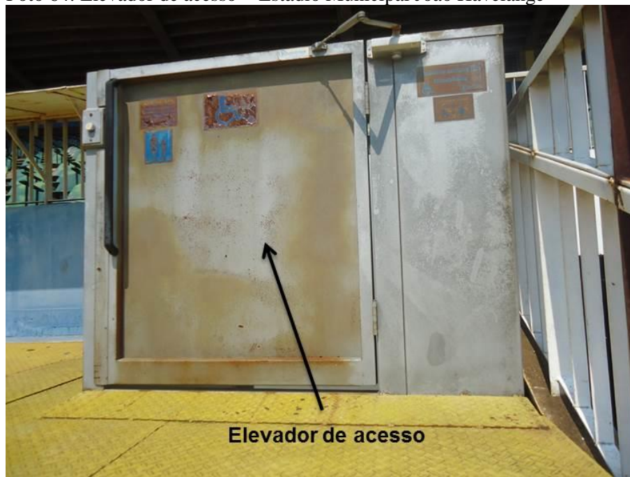
Foto 64: Elevador de acesso - Estádio Municipal João Havelange
