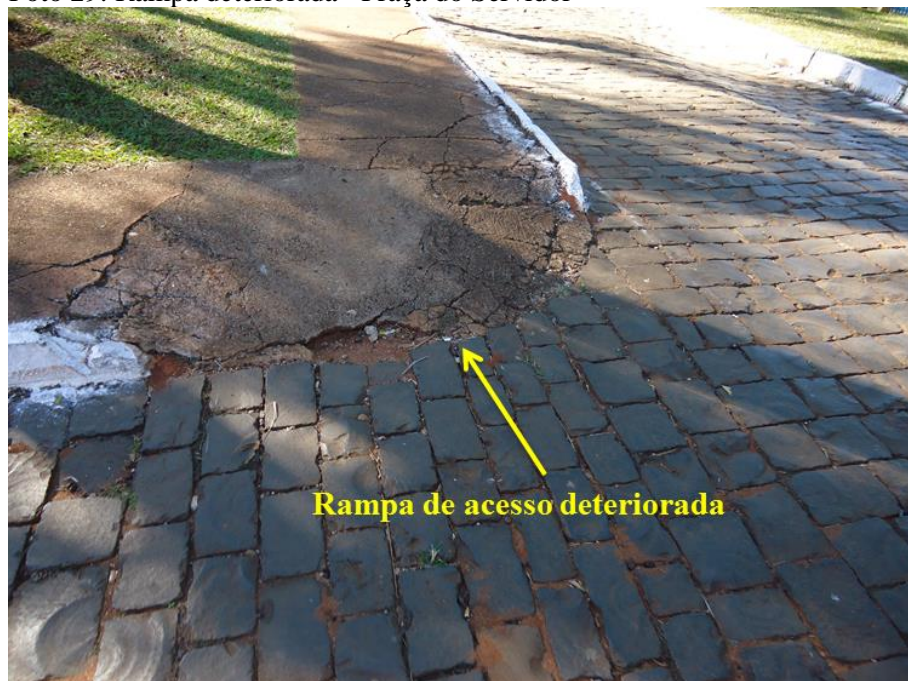
Foto 29: Rampa deteriorada - Praça do Servidor
