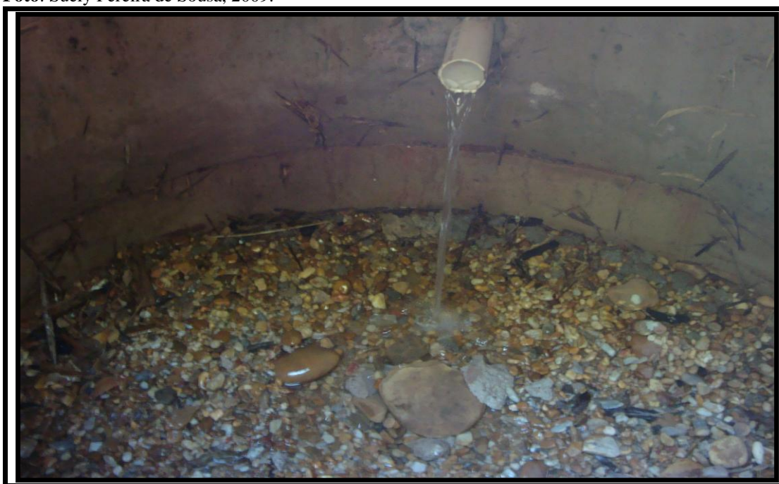
Figura 30: Caixa de infiltração preenchida por cascalho. Foto: Suely Pereira de Sousa, 2009.
