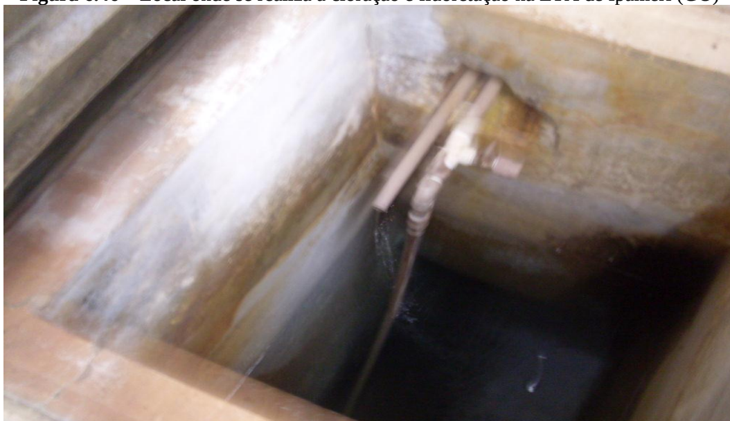
Figura 6.46 – Local onde se realiza a cloração e fluoretação na ETA de Ipameri (GO)
