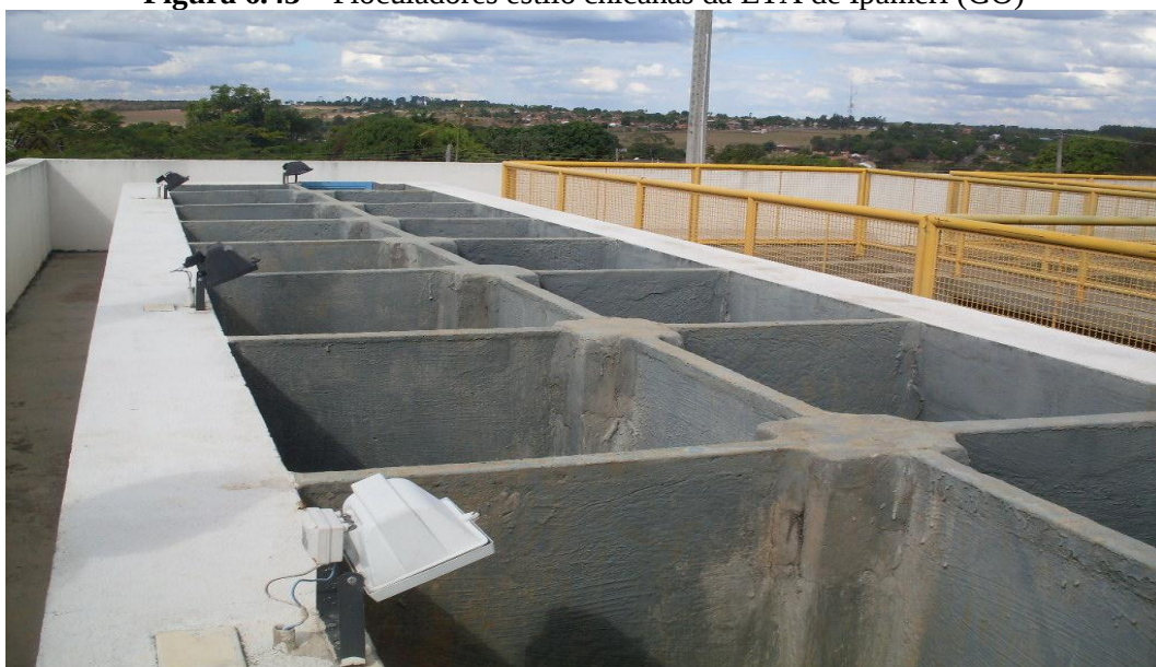
Figura 6.43 – Floculadores estilo chicanas da ETA de Ipameri (GO)
