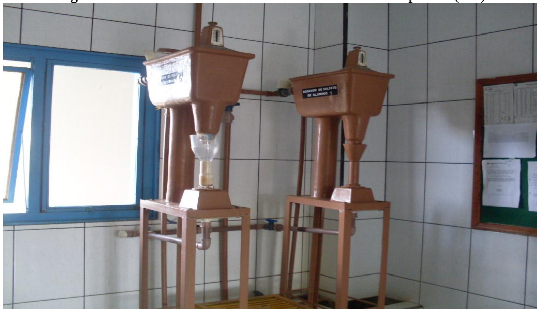
Figura 6.41 – Dosador de sulfato de alumínio da ETA de Ipameri (GO)
