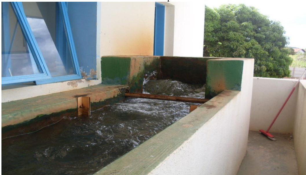
Figura 6.42 – Calha Parshall da ETA de Ipameri (GO), local onde se aplica cal hidratada e é induzida a mistura rápida
