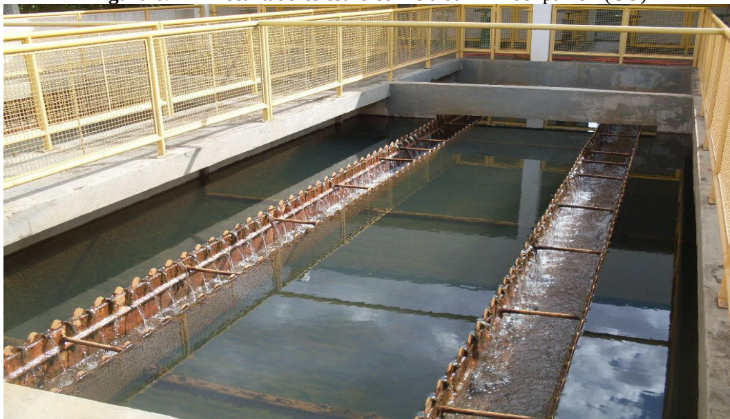
Figura 6.44 – Decantadores estilo colmeia da ETA de Ipameri (GO)
