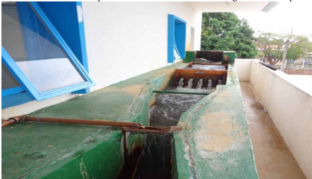
Figura 6.40 – Estrutura utilizada para adicionar sulfato de alumínio na água da ETA de Ipameri (GO)
