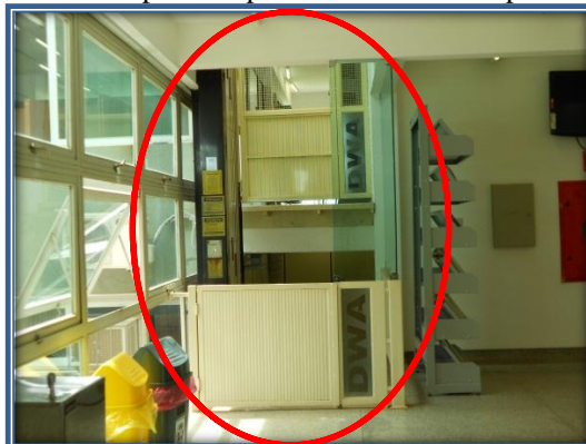
Fotografia 5 – Detalhes da porta da plataforma elevatória para acesso à Biblioteca
