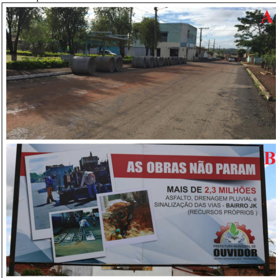
Fotografia 11 - A e B - Implantação de Sistemas de Drenagem Pluvial no Bairro JK em Ouvidor. Foto A: material para obra na Rua Dona Germana. Foto B: placa instalada no local - Ano 2019
