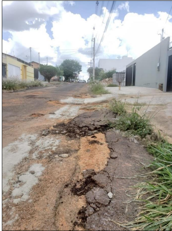
Fotografia 1: Asfalto comprometido no bairro Jardim Paraíso.
