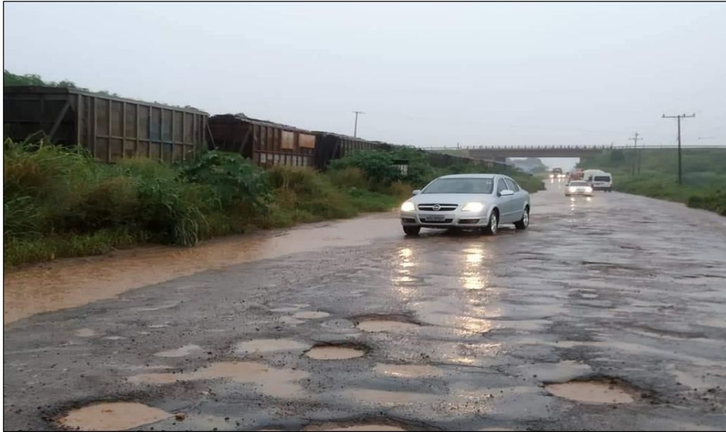
Fotografia 2: Asfalto comprometido no Loteamento Santa Mônica.
