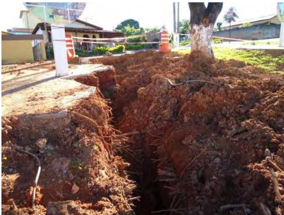
Foto 24 Mostra raízes de árvore interrompidas pelo serviço de manutenção de água e esgoto de Catalão (GO). Autora: ROCHA, I.S. da S.(2010)
