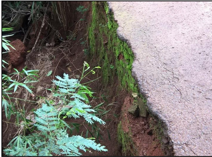
Figura 32: Processo erosivo as margens da Alameda Marília de Dirceu – Uberlândia.
