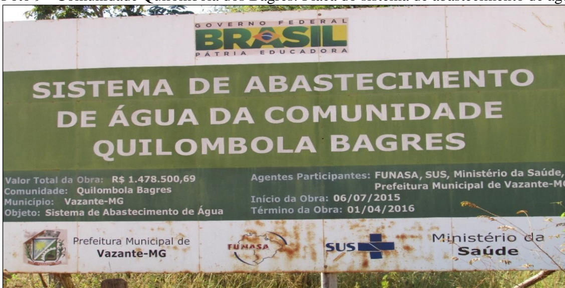
Foto 9 - Comunidade Quilombola dos Bagres: Placa do sistema de abastecimento de água.
