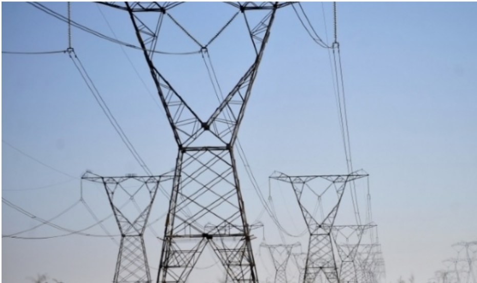
Figura 1.3 – Torre de transmissão de energia
