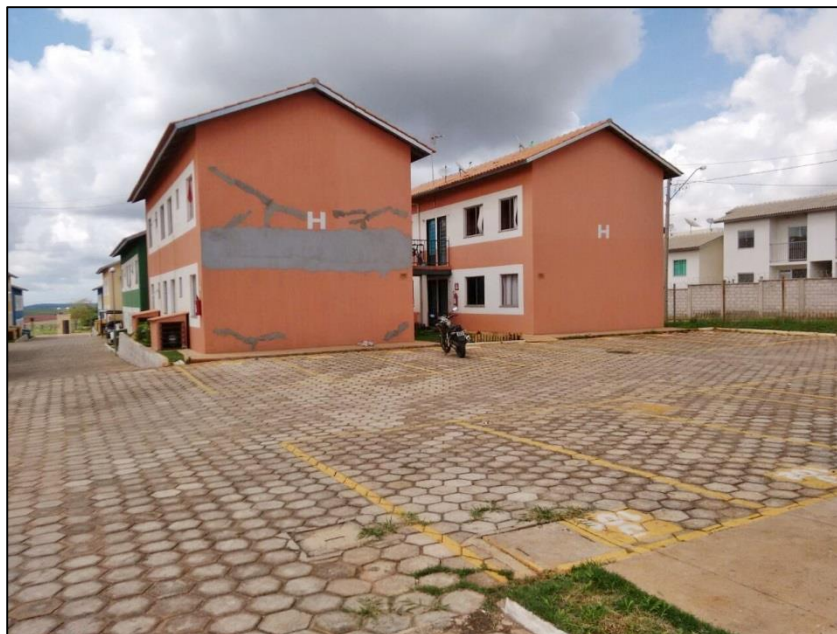
Foto 6 - Residencial Maria Amélia II em Catalão (GO): Rachadura na parede do Bloco H em setembro de 2016
