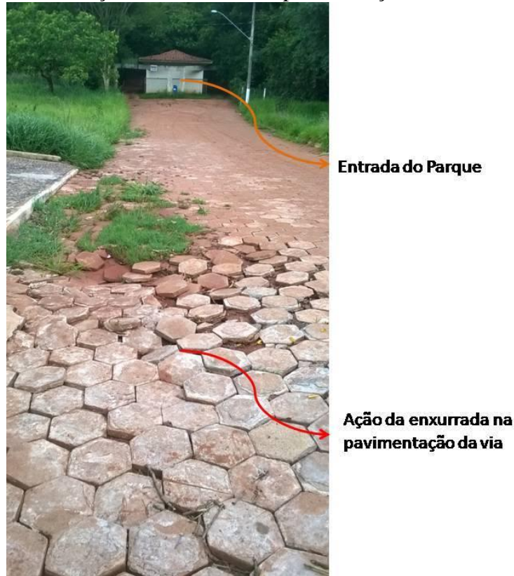
Figura 48 - Ação da enxurrada na pavimentação da via de acesso
