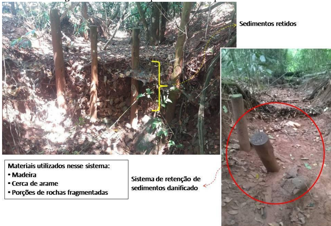
Figura 55 - Barramento para controle do processo erosivo
