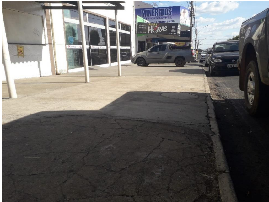
Foto 7 – Guia elevada em contraste com a guia rebaixada na calçada da Avenida Dr. Lamartine Pinto de Avelar
