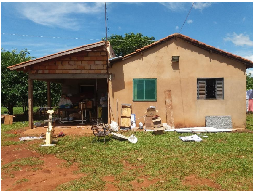
Foto 6 – PA Chico Mendes em Ituiutaba (MG): residência inacabada – 2016.
