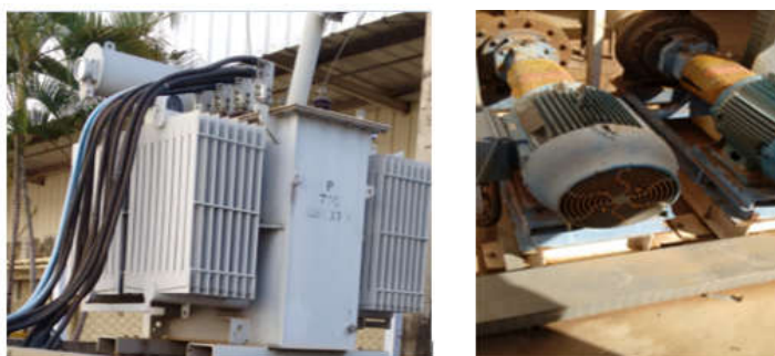
Figura 11 – Transformador de energia elétrica e motor elétrico
